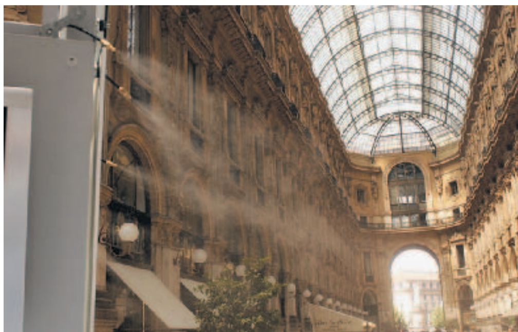
Nuova «nebbia» a Milano. Un impianto della Neotech rinfresca l'ambiente in Galleria Vittorio Emanuele
